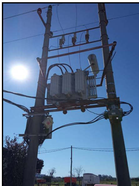
Figura 10– Vista trasera de la subestación SE 4421156
