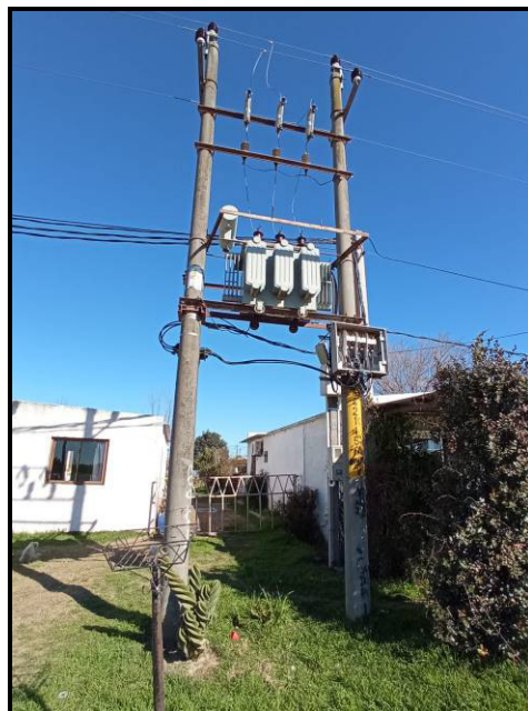
Figura 9– Vista frontal de la subestación SE 4421156
